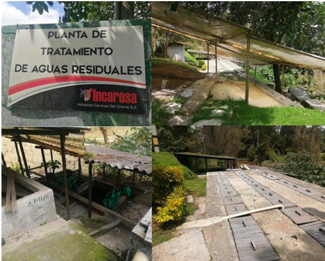
Imagen: Planta de Tratamiento de Aguas Residuales -INCAROSA-
