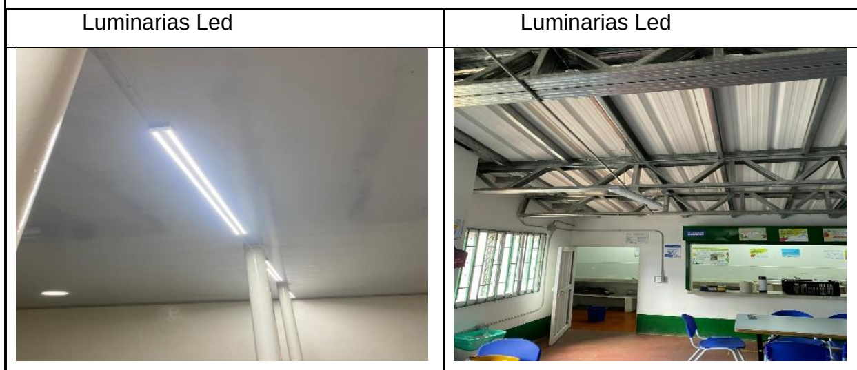
Imagen 4. Luminarias Led Institución Educativa
