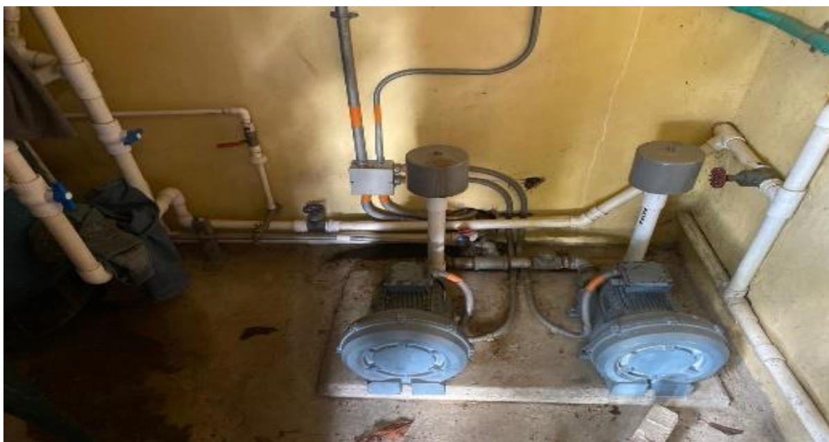
Imagen 3. Funcionamiento de Planta de Tratamiento de Aguas Residuales
